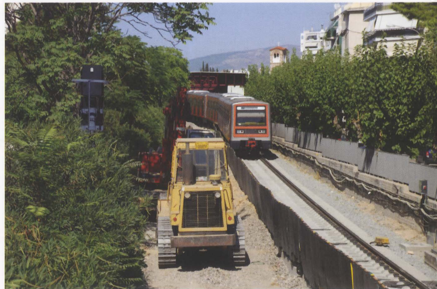
Πριν τον σταθμό Άνω Πατήσια, εργασίες κατασκευής του υποστρώματος στην γραμμή καθόδου. Φωτογραφία Γρηγόρης Καραθανάσης.
