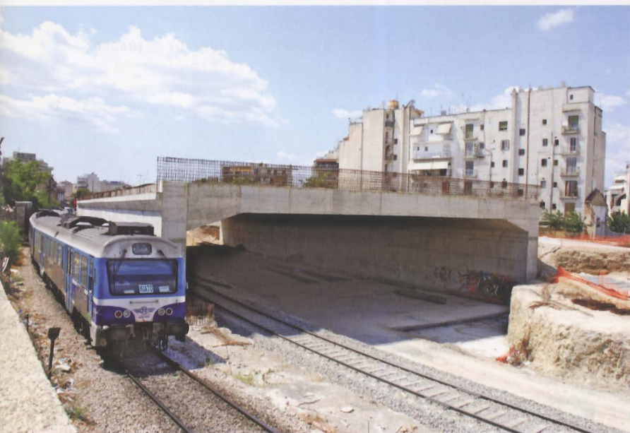
Πριν την εκτροπή της κυκλοφορίας κάτω από το τεχνικό έργο στην οδό Σιδηροδρόμων. Φωτογραφία Γρηγόρης Καραθανάσης.
