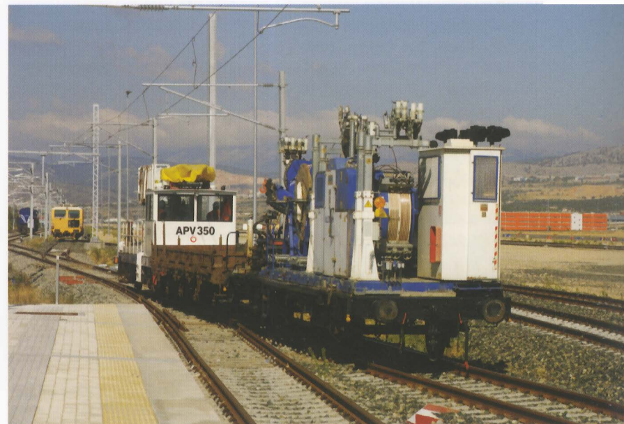
Οχήματα για την κατασκευή της Ηλεκτροκίνησης στον σταθμό Θριασίου. Φωτογραφία Γρηγόρης Καραθανάσης.
