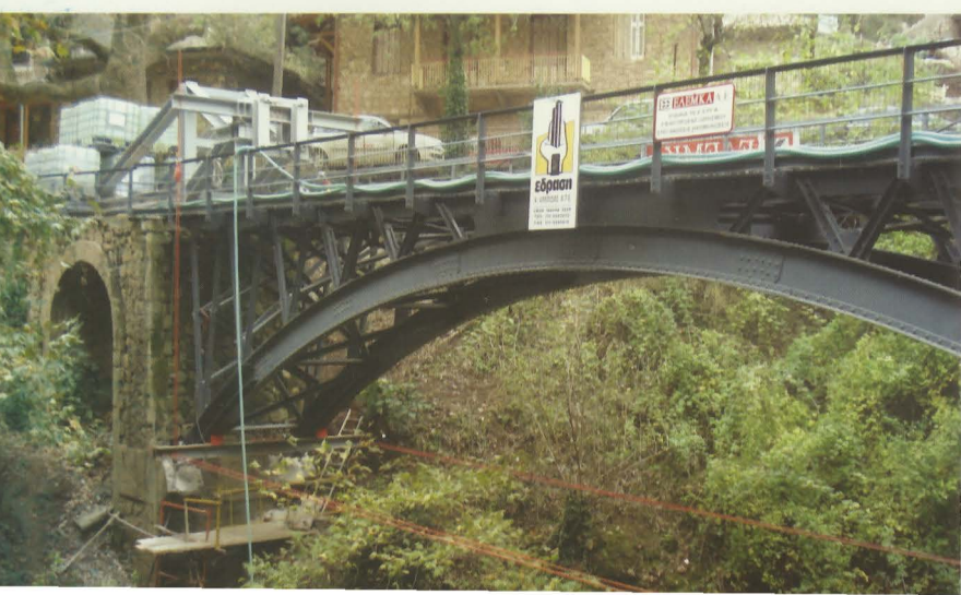
Ανακαίνιση γραμμής Οδοντωτού (Διακοπτό - Καλάβρυτα). Γέφυρα της Ζαχλωρούς. Αριστερό ακρόβαθρο διακρίνεται το ικρίωμα και οι δεξαμενές για το αντίβαρο. Φωτογραφία: Τάσος Καραγκούνης.
