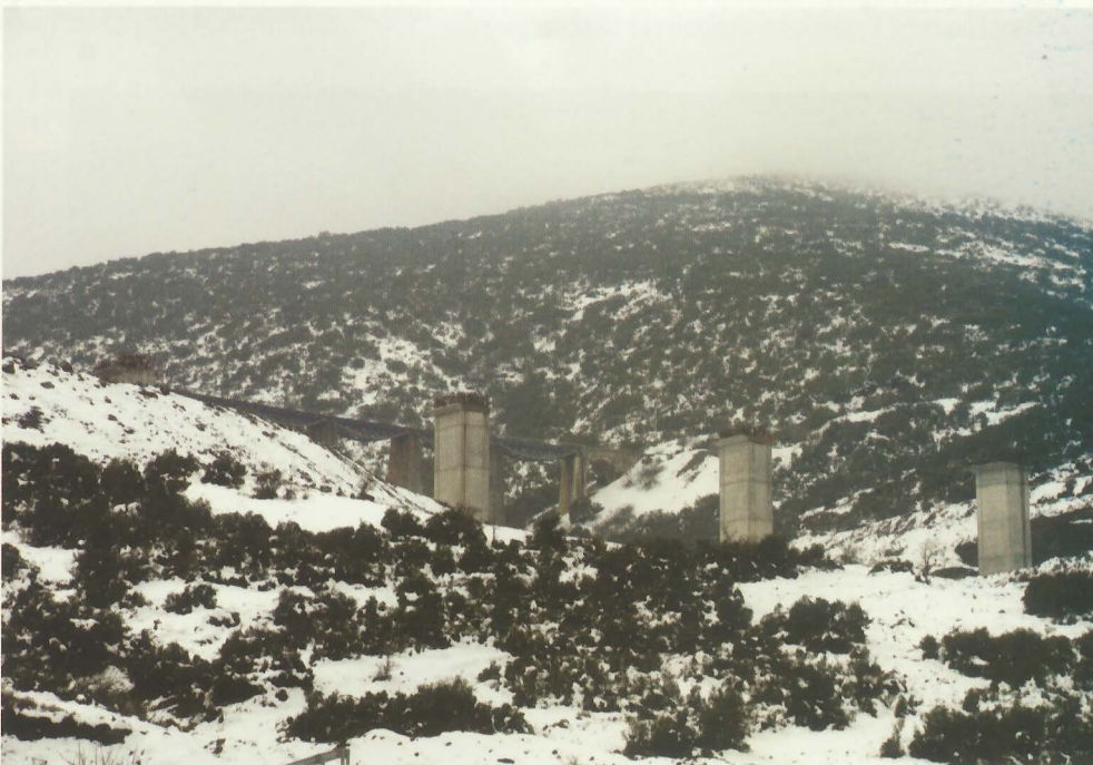
Τμήμα Λειανοκλάδι - Δομοκός. Τα βάθρα της γέφυρας ΣΓ 25 είναι σχεδόν τελειωμένα. ΓΚ. Φωτογραφία: Γρηγόρης Καραθανάσης.
