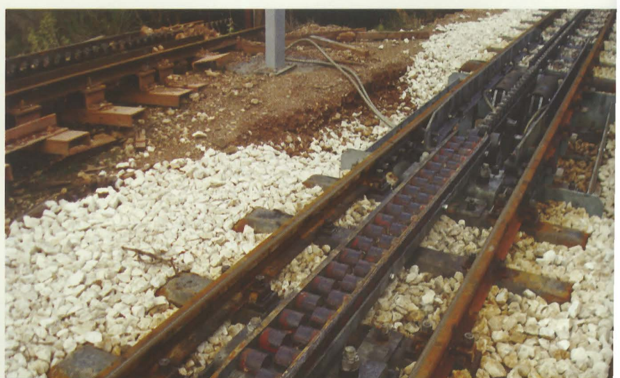
Ανακαίνιση γραμμής Οδοντωτού (Διακοπτό - Καλάβρυτα). Είσοδος στην οδόντωση, διακρίνεται το ορχικό στάδιο με το ράουλα, πριν την κυρίως οδόντωση. Φωτογραφία: Μανώλης Τζεβελεκάκης.
